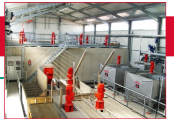
WINfeed® Flüssigfütterung Vormischzentrale
