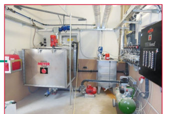
Unterfütterzentrale Mast Sensor
