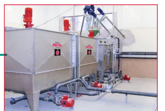
Unterfütterzentrale Sauen Restriktiv
